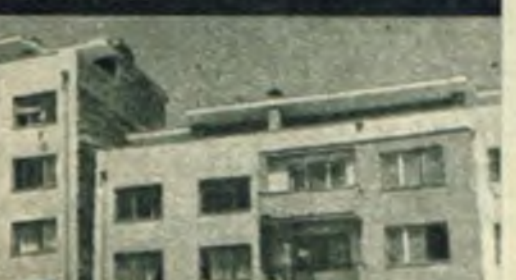
W czasie trzęsienia ziemi jedno piętro domu apadło się pod ziemię
