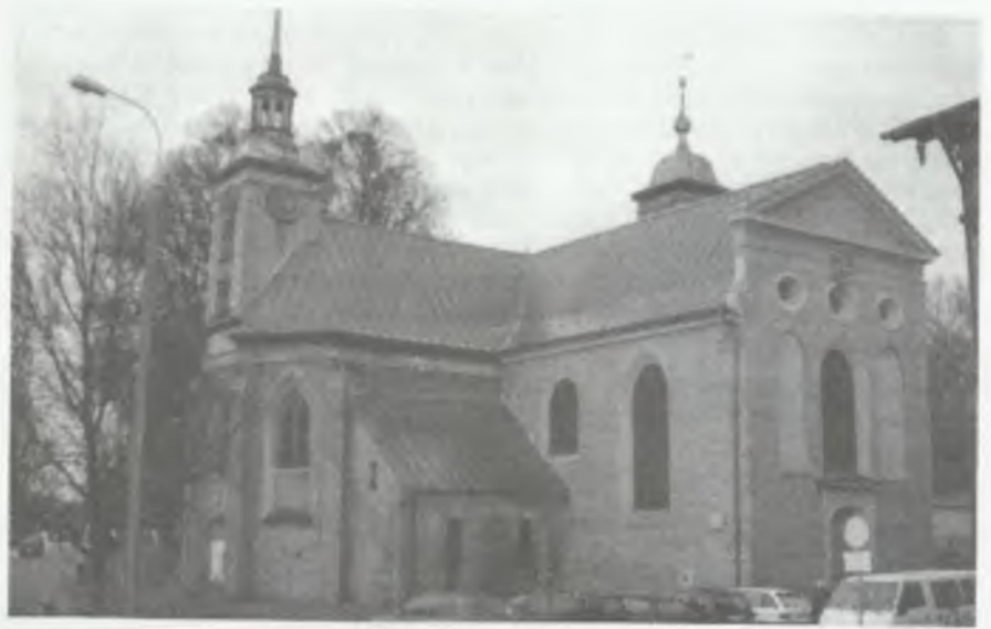
Fronton kościoła pw. Bożego Ciała po renowacji dachu, murów i stolarki drzwiowej. U góry widoczny karusz z herbem Gdańska
